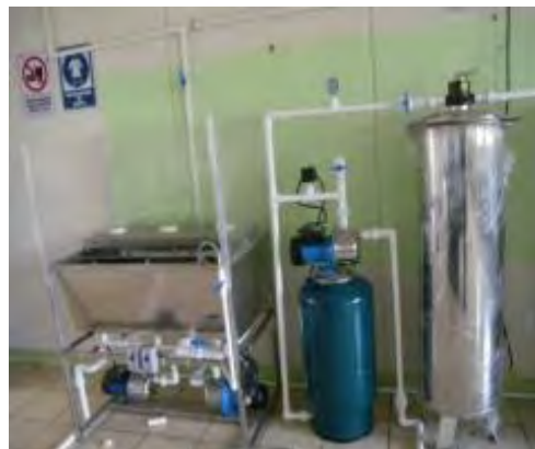
Instalaciones de la purificadora de agua del TESOEM
